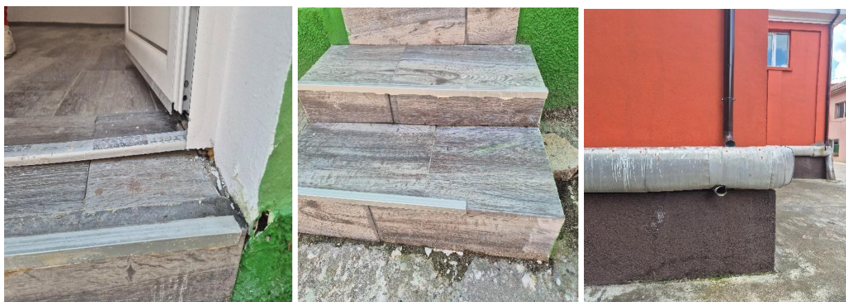
Голяма фуга под прага на външна врата, нефугирани и без лайсна стъпала и водосточна тръба до средата на стената
