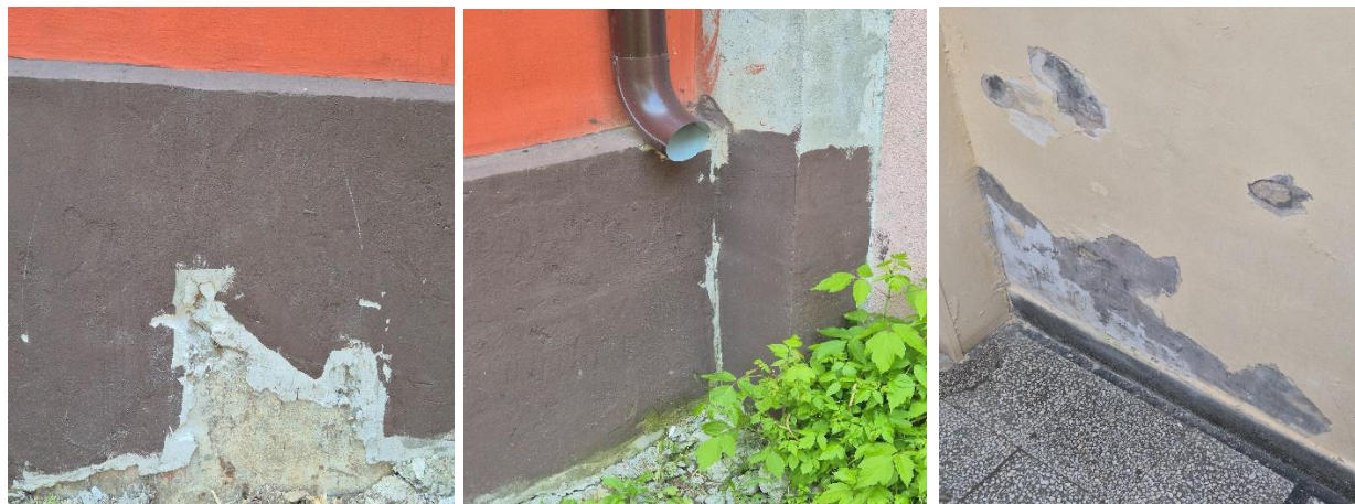
Рушаща се външна мазилка, къса водосточна тръба, която мокри фасадата и паднала мазилка
